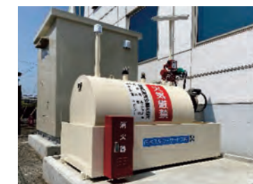
総合会館非常用発電設備用燃料タンク
