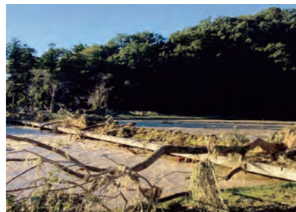
令和元年東日本台風時の鞍掛橋(神戸)
