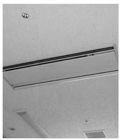
総合福祉エリアの空調機
