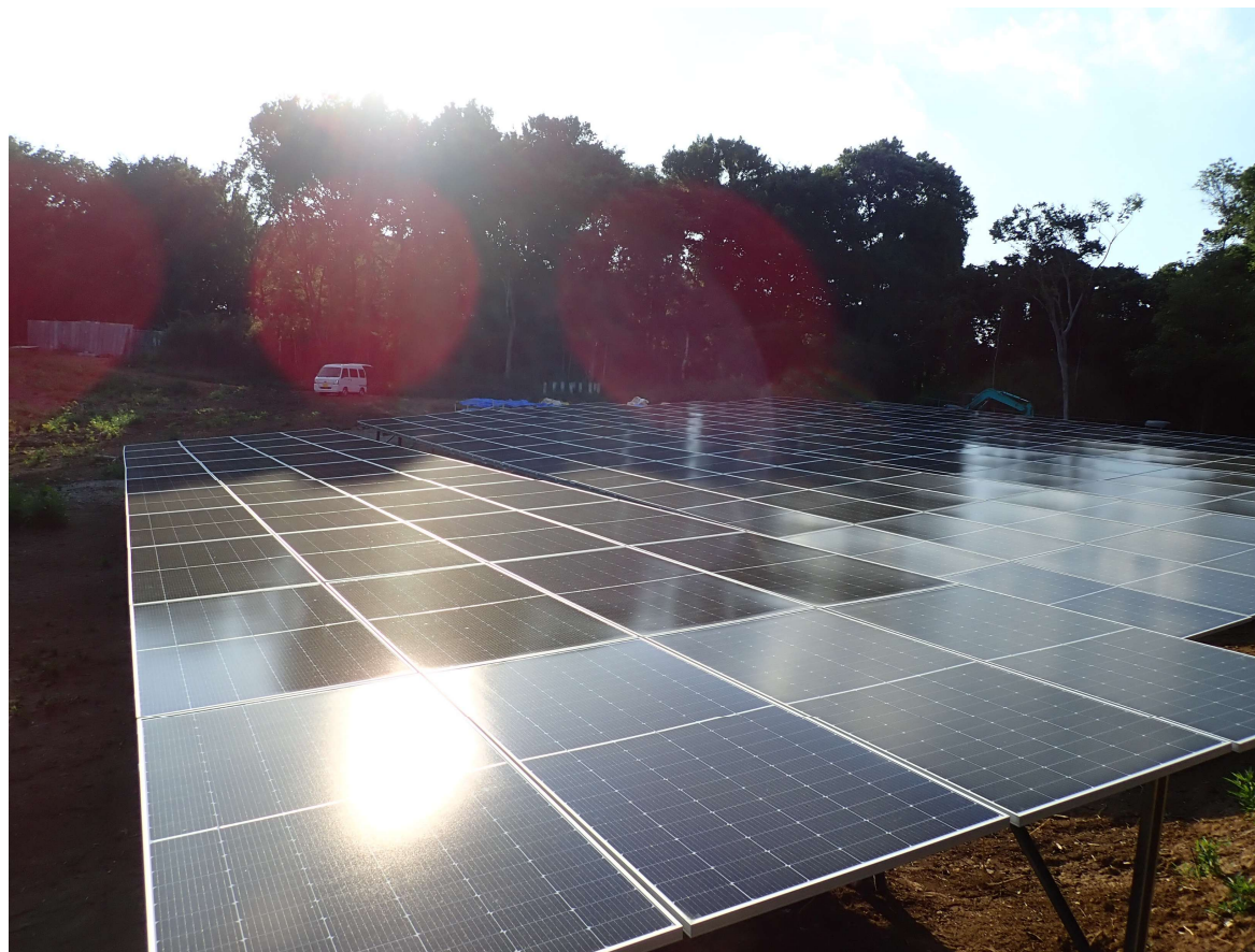
※株式会社丸進工営_東松山市第3発電所（2023年7月25日_16時41分_撮影）
