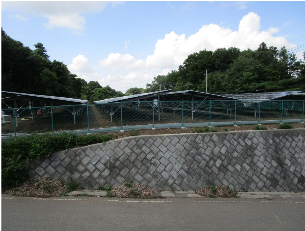
※参考写真：東松山市第2発電所（株式会社丸進工営 所有施設）
