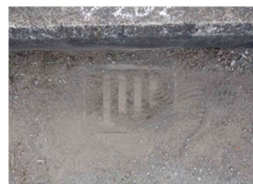
排水ますの土砂詰まり
