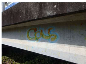
主桁の落書き
