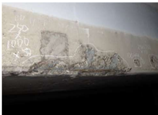
主桁の鉄筋露出
