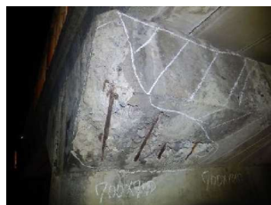
橋脚のうき,鉄筋露出
