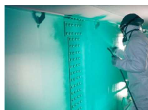
〈対策例〉塗装塗替え工
