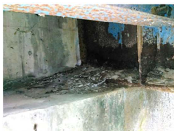
支承部の土砂堆積
