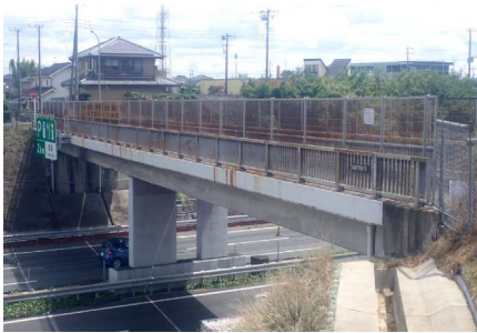
西本宿二号橋（健全度Ⅲ）
