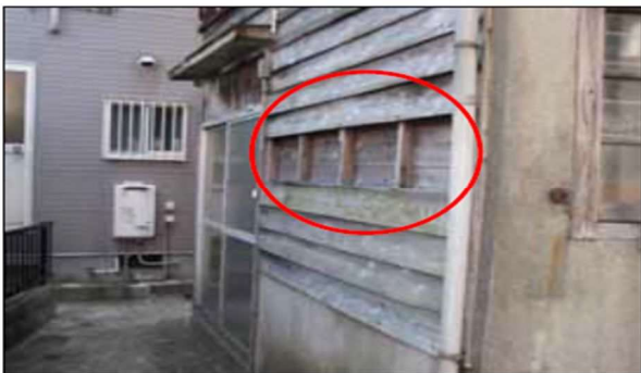
外壁の仕上材の一部がはがれ、 下地が露出している例（評点 1 5）
