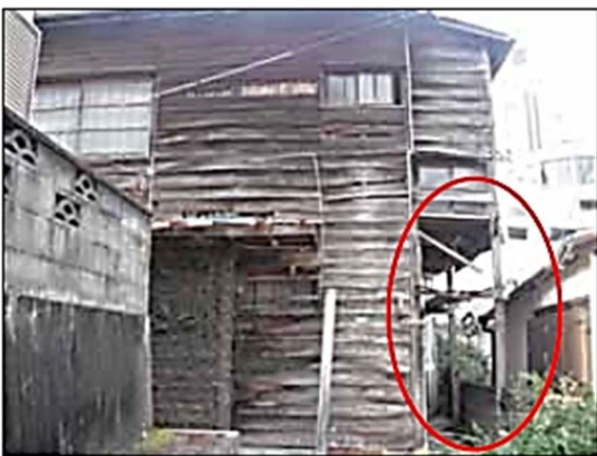
柱の数箇所に破損がある例（評点50）
