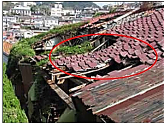
柱、はりの破損や変形が著しく崩壊の危険がある例（評点100）
