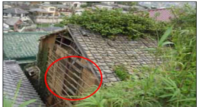
外壁が剥落し、著しく下地が露出するとともに、 壁体を貫通する穴を生じている例（評点 2 5）
