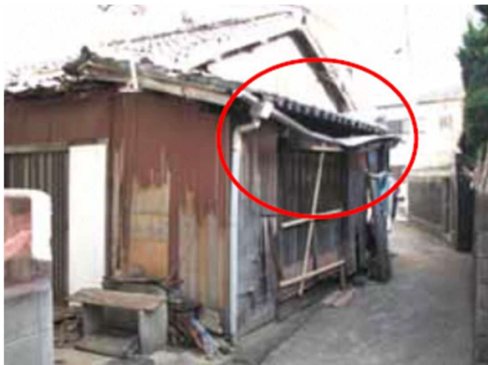
雨樋が壊れており、機能的には雨樋がないと同様の例（評点10）
