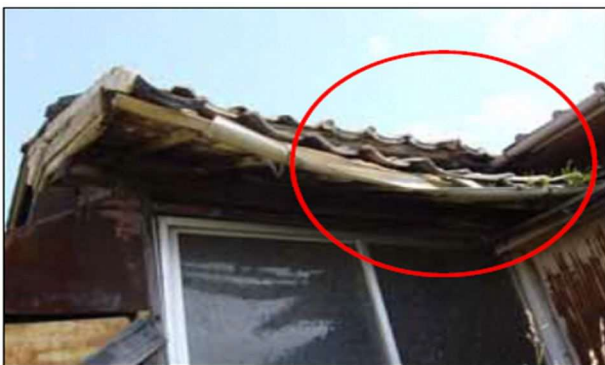
軒の裏板、たる木等が腐朽し、 軒が垂れ下がっている例（評点 2 5）
