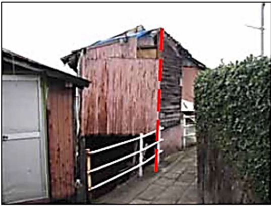
一部の柱が傾斜している例（評点25）
